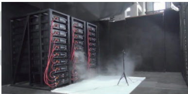
(d) Thermal runaway in Cell 38
