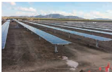
オーストラリア 128MW Clare solar farm
